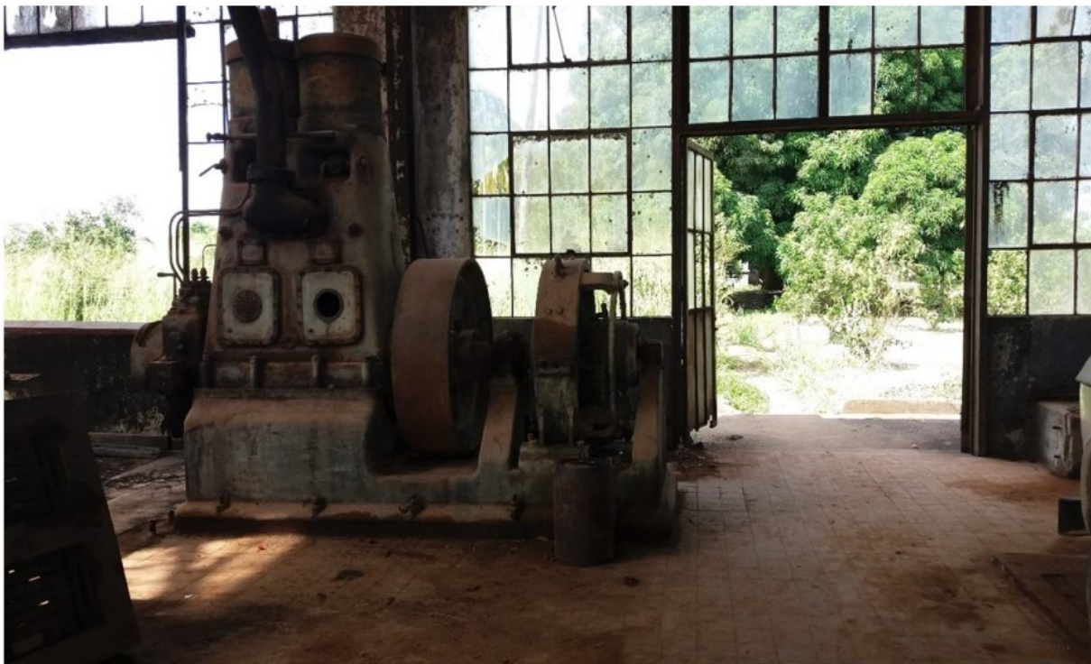
Figura 59 - Uma das duas grandiosas caldeiras movidas à lenha no galpão de máquinas.
