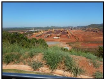
S11D: pátio de minério de Fe
