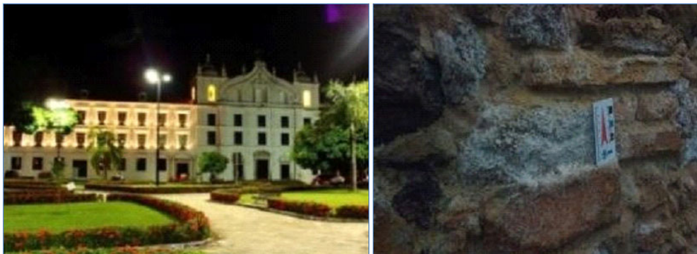
Figura 14. À esquerda, fachada do museu, Imagem: Mariana e Fabricio, 2014. – à direita, detalhe da parede interna do prédio mostrando a eflorescência. Imagem Giovana Miranda.
