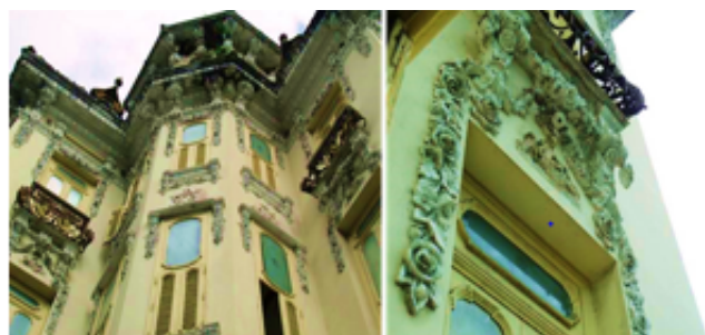
Figura 1. b) Vistas dos ornamentos em estuque da fachada do Palacete Bolonha, construído em 1915.
